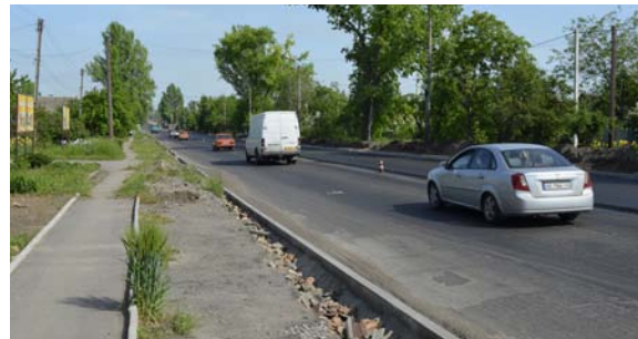
Ремонт №23 – без дренажної системи.
